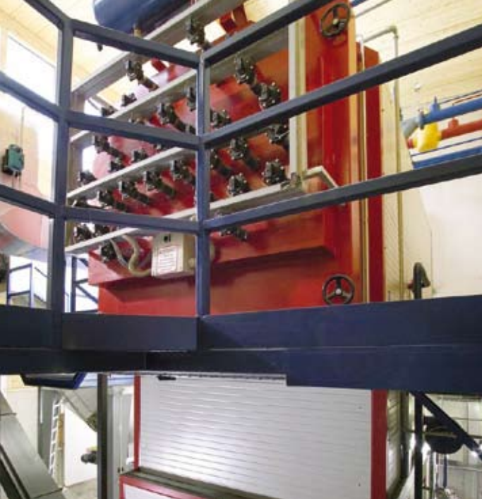
Die Feuerungseinheit bildet das Herz der Holzszchnitzelheizung.
